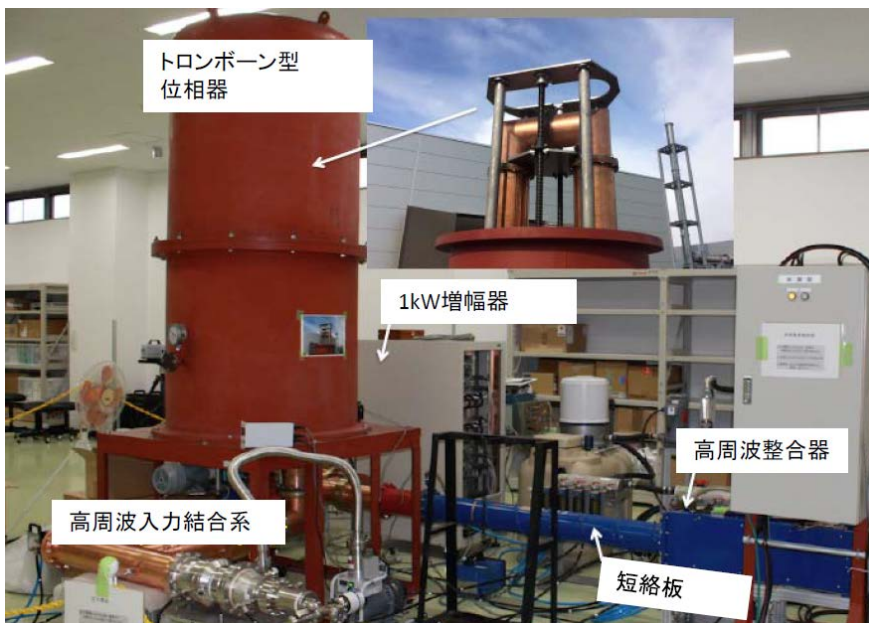
図5:六ヶ所核融合研究所に据え付けた試験設備。高周波進行波と反射波の定在波を用いた耐電力試験装置で730Wの入射電力で等価的な高周波電力200kWを試験できる。
