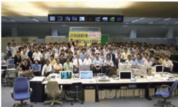
JT-60 中央制御室 (2008年8月29日 JT-60 実験運転完遂の様子)
