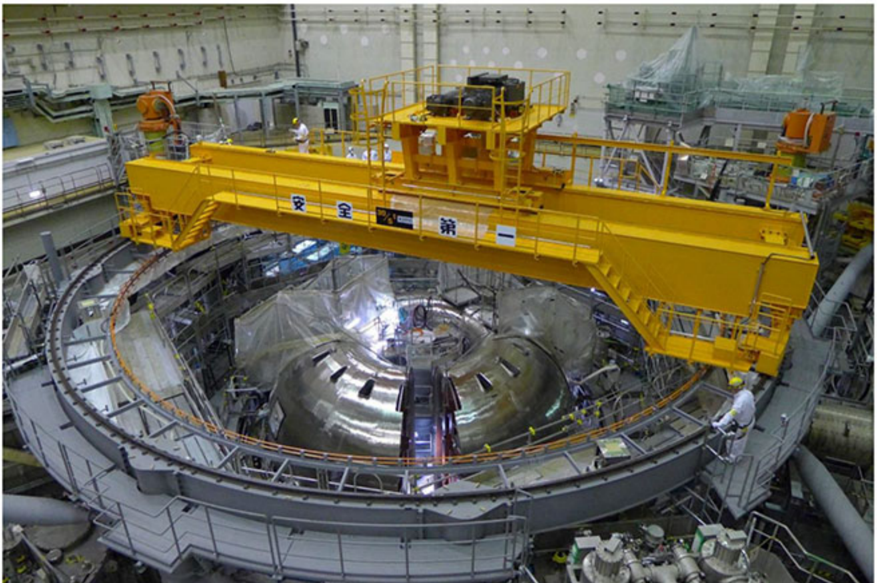
図9: 落成検査を終了し、運転を開始した旋回クレーン
