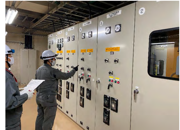
停電前電圧確認(屋内電気室)
