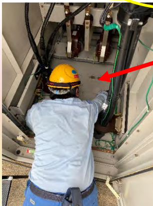
配電盤内点検清掃 (小動物等の侵入確認も行う)
