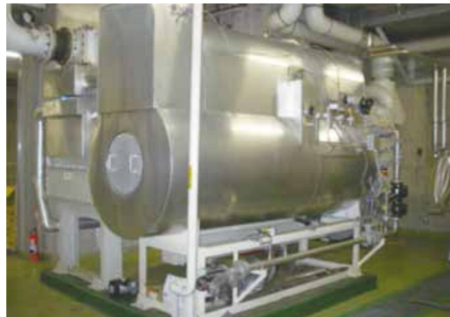
図5 二重効用ガス炊吸収冷温水機
