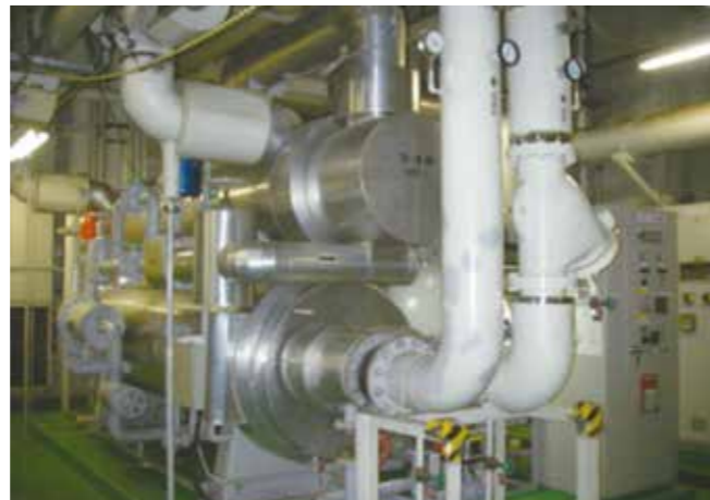
図6 熱回収型水熱源スクルー冷凍機
