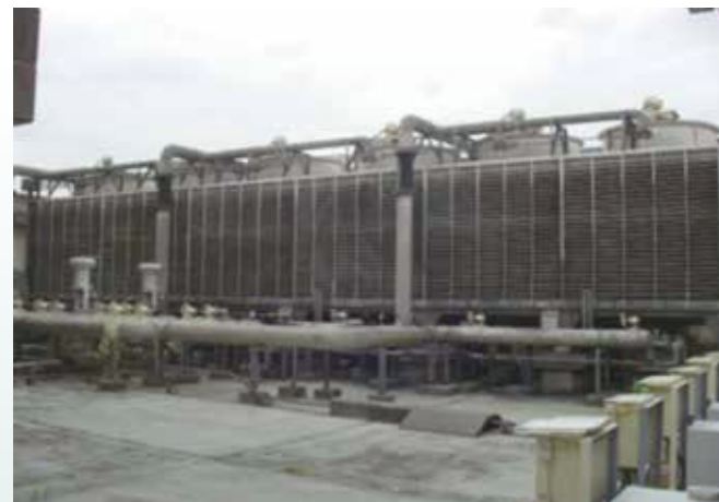
図4 二重効用ガス炊吸収冷温水機冷却塔
