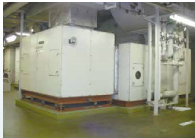
図7 一次空調機(冷暖房機)
