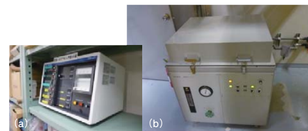
図14: (a)監視盤 (b)ダストモニタ
