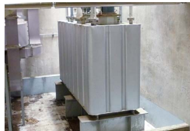
図11:RI貯留タンク
