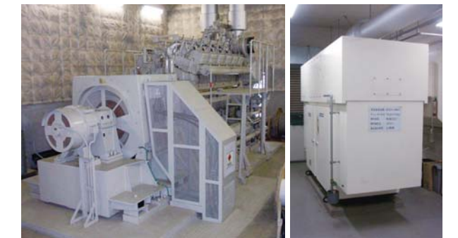
図2: 特高変電所の発電機(2000kVA)(左)と画像診断棟の発電機(60kVA)(右)
