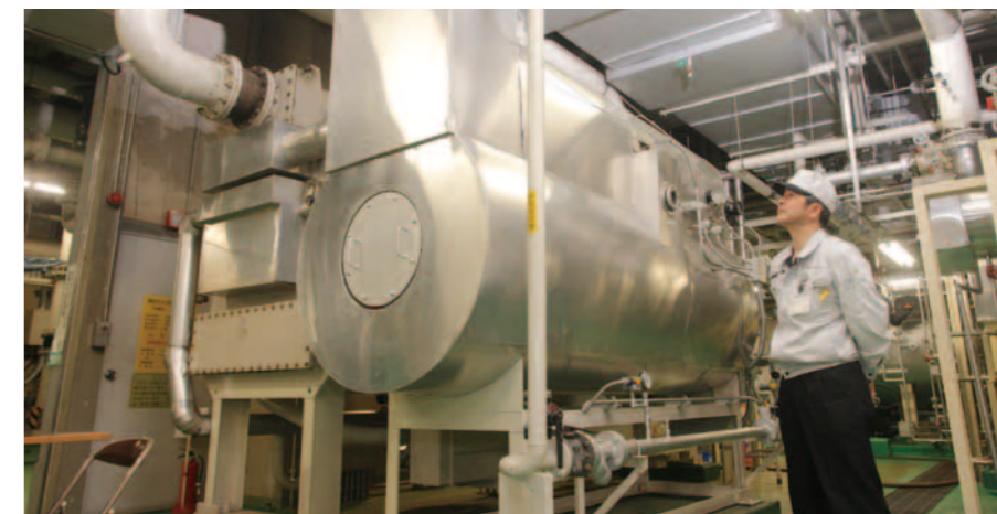
巨大な設備を象徴する機器がいくつも並ぶ、重粒子線棟の地下室の一コマ。
