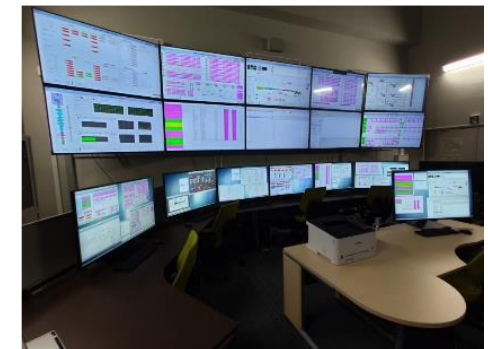
LIPAC遠隔実験制御室
