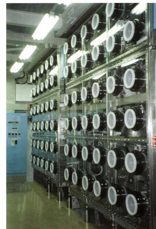
MOX燃料製造設備
