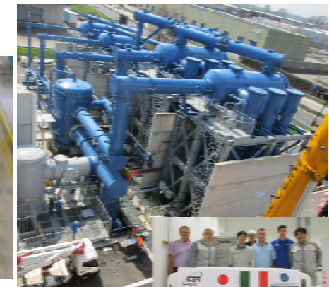
NBTF高電圧機器受入試験 (2018年9月)
