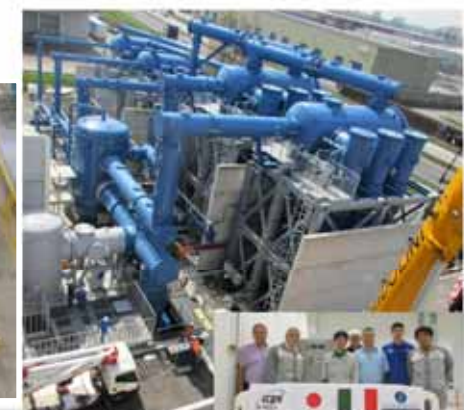
NBTF高電圧機器受入試験 (2018年9月)
