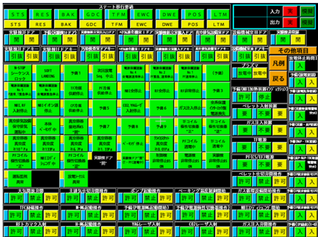
図4 統括制御運転班卓上タッチパネル（保守モード）画像
