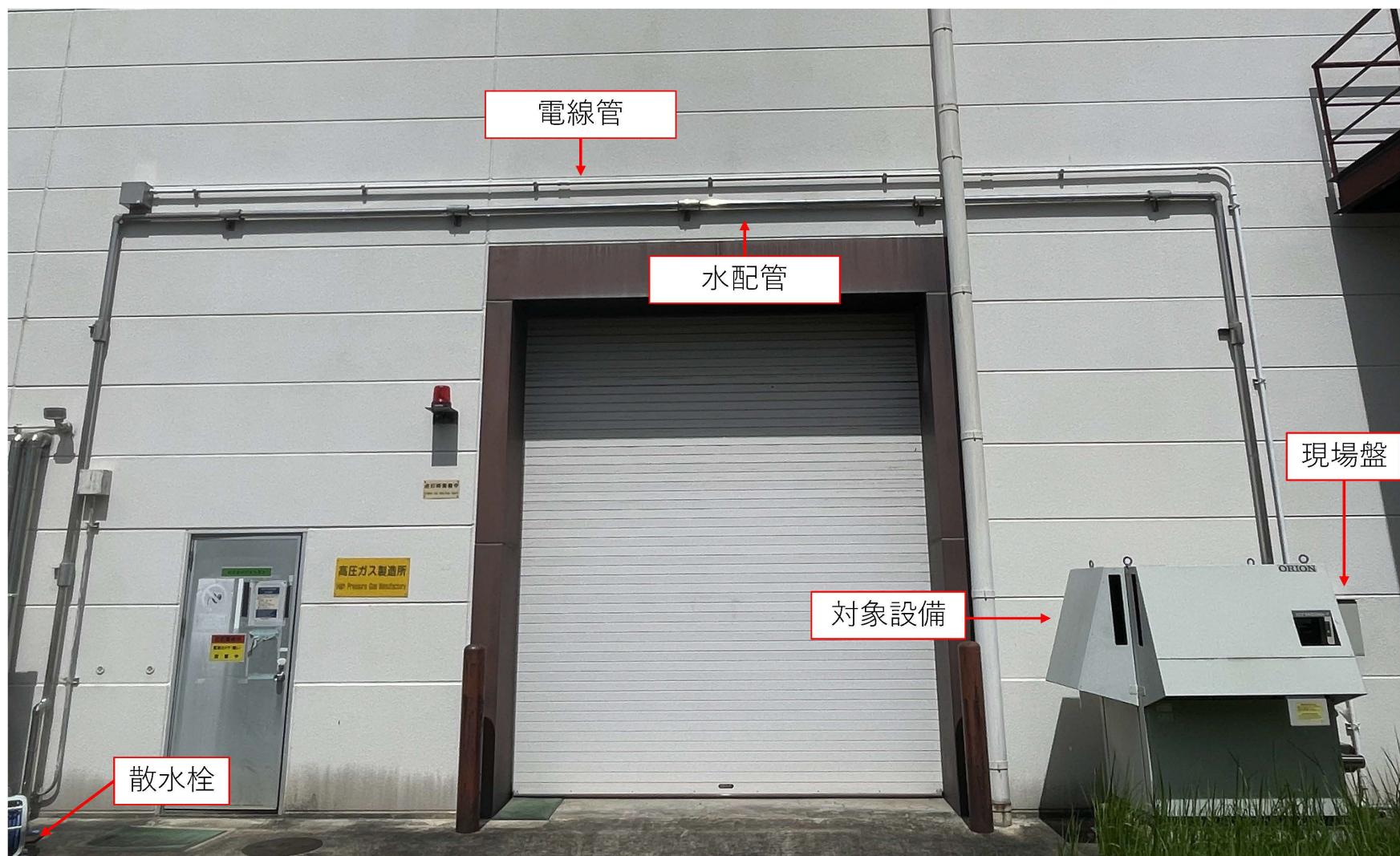
図1 機器設置状況
