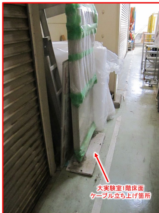
図 3 : 大実験室 1 階床面ケーブル立ち上げ箇所
