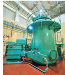
電子線照射施設 (供用中)
