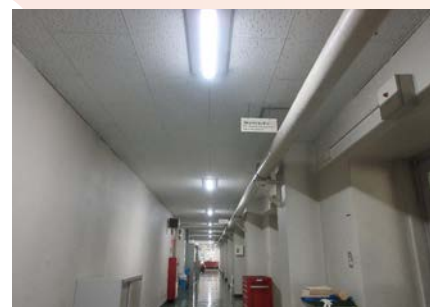
照明器具のLED化
