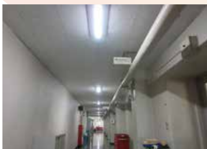
照明器具のLED化
