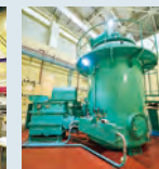
電子線照射施設 (供用中)
