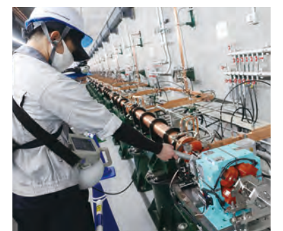
加速器の保守作業
