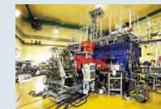
イオン照射研究施設 TIARA (供用中)
