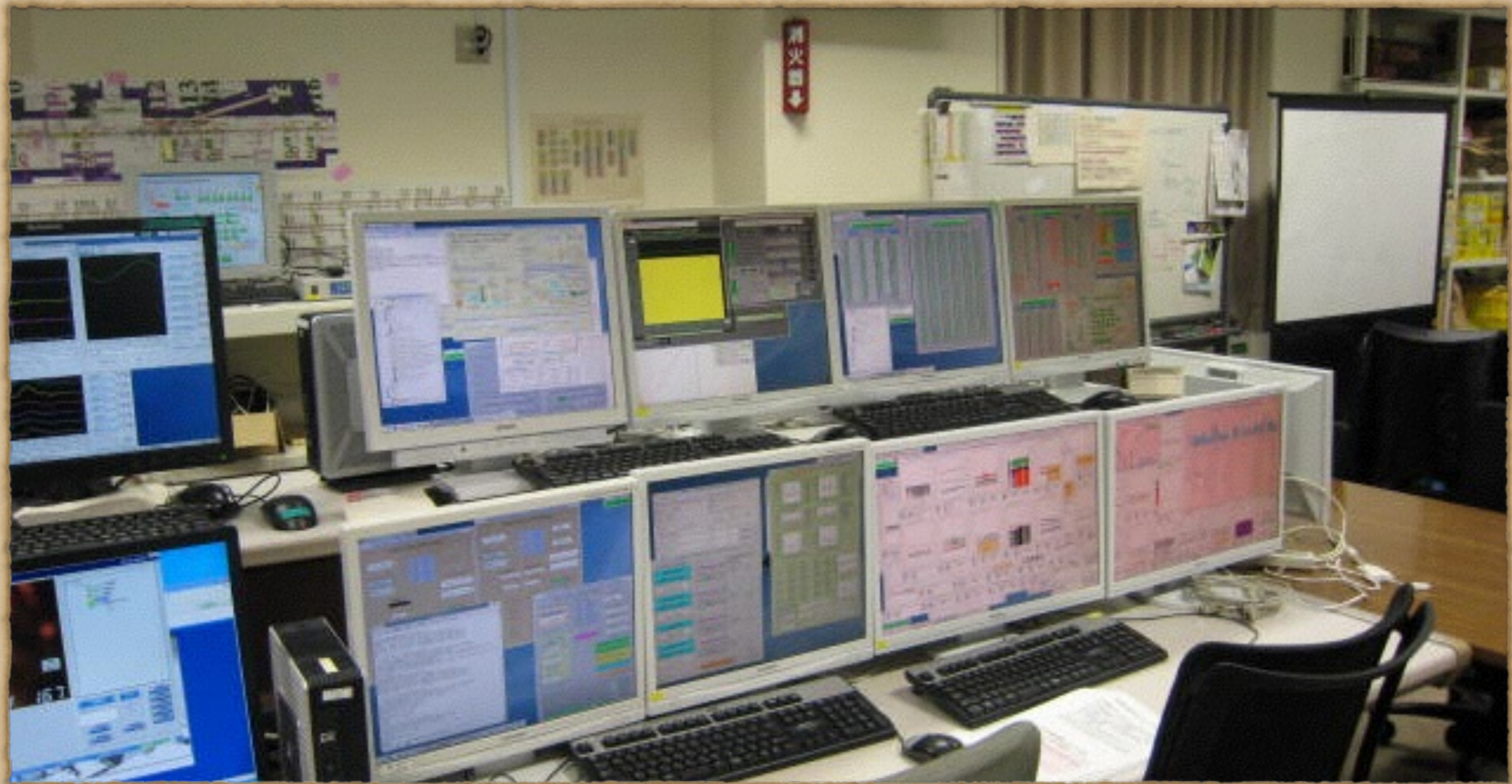
J-PARC加速器中央制御室
