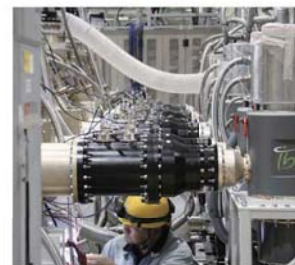
材料照射施設の原型加速器の一部である、高周波四重極線型加速器の高周波電源
