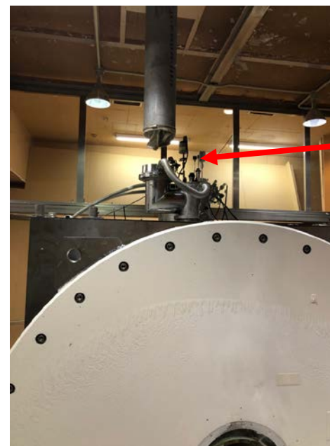
破損した 上部配管 の一部
