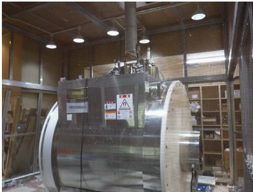
破損したMRI装置
