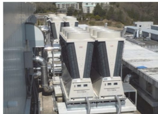
関西研播磨地区 モジュールチラー冷凍機 (6台)
