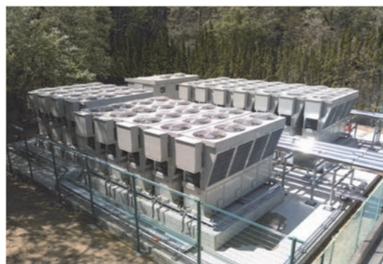
関西研木津地区 モジュールチラー冷凍機 (16台)
