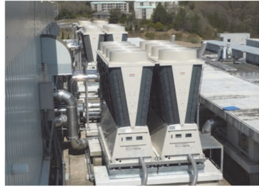
関西研播磨地区 モジュールチラー冷凍機 (6台)
